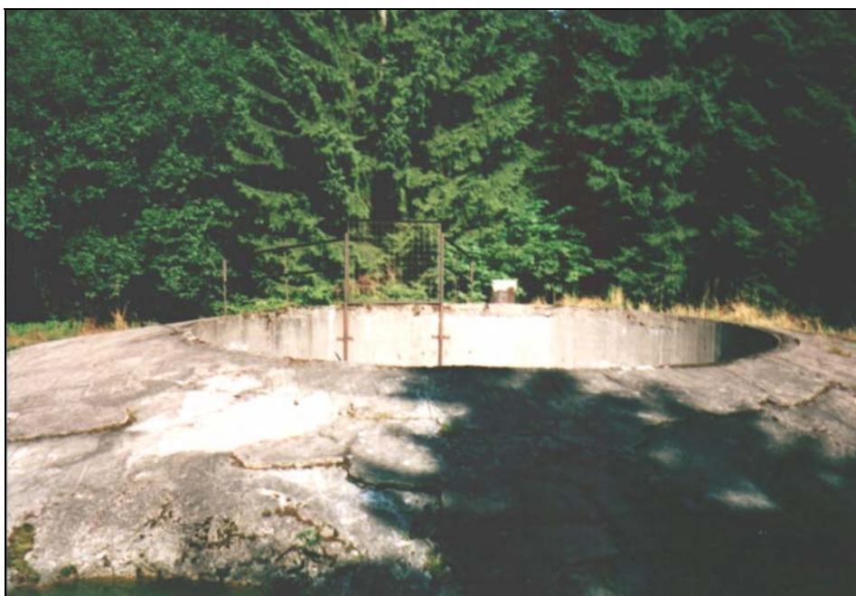
Obr. 4 Šachta určená k osazení tvrzové dělostřelecké věže K–Ba–S 22 „Horymír“. Tvrz „Bouda“ v Orlických horách. Foto M. Vlach
